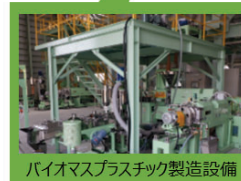
バイオマスプラスチック製造設備
