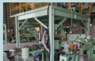
バイオマスプラスチック製造設備
