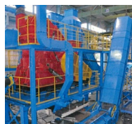
金属破碎・選別設備
